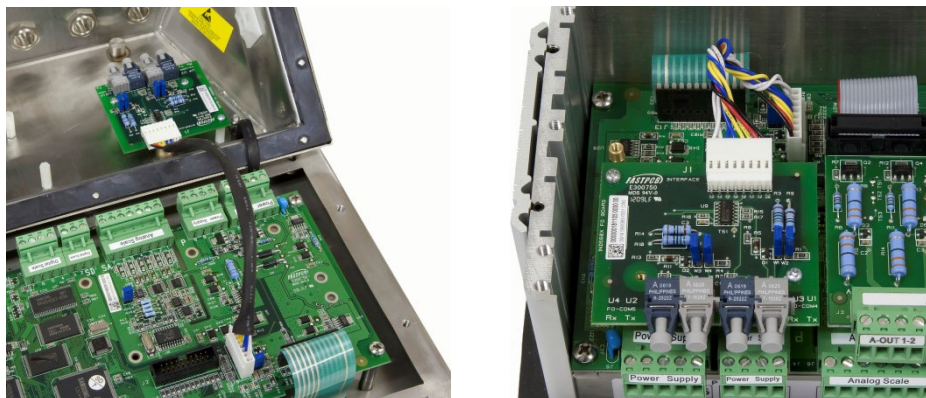
Figura 3-42: Placa de interface de fibra óptica
